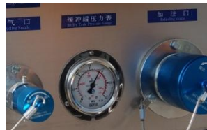
缓冲罐压力表
